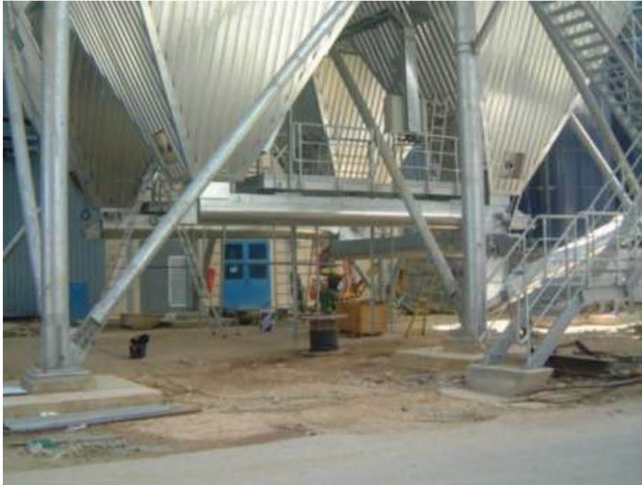
Schneckenförderer unter E-Filter Aschetransport in Holzverbrennungsanlage Schnecke 7.500 mm lang ohne Mittellager
